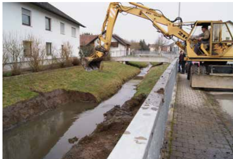
Räumung des Perlbachs in Oberzeitldorn, Hauptstraße 2014
