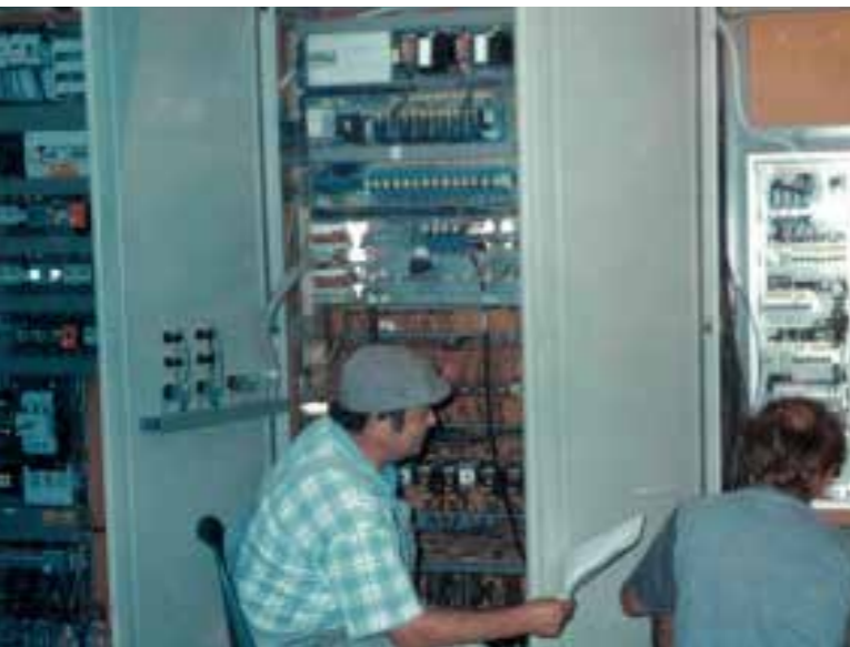
Schaltraum der Kläranlage 1999
