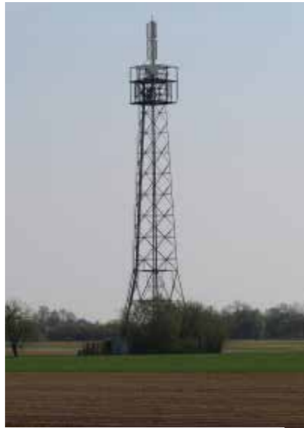
Mobilfunkmast (D 1) nördlich von Kirchroth 2018
