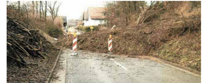
2006 Erdbeben auf der Kreisstraße in Obermiethnach Straubinger Tagblatt 30.3.2006
