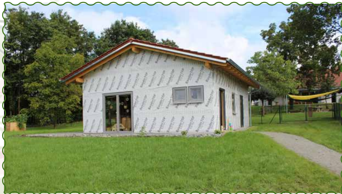
Das Gruppenhäuschen der Donaufüchse - im Herbst wird das Gebäude noch mit Holz verkleidet, damit es einen Hüttencharakter bekommt
